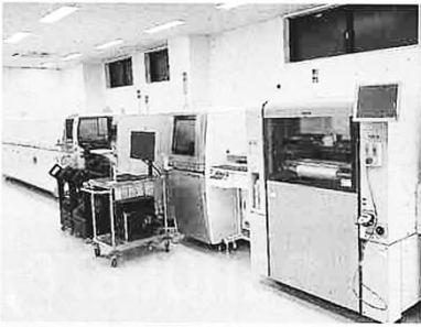
テクニカルセンタースペース1階 「テクニカルセンタースペース」(1階)
